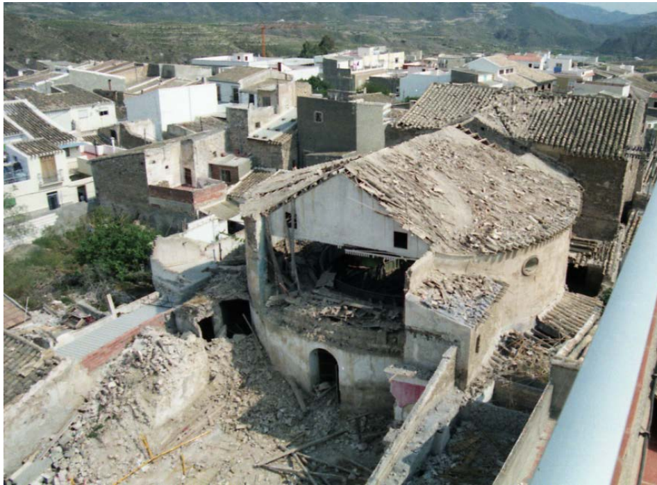
Vista del Teatro Cervantes durante su demolición (ejecutada a instancia municipal a principios de los años 90). En la misma aun se puede apreciar como la entrada ya ha sido demolida y como aun queda en pie la parte que albergaba el patio de butacas y palcos (de forma circular) y la parte destinada al escenario de forma rectangular.
